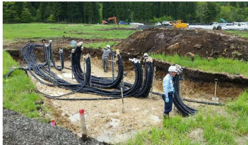
PCS基礎内 埋設配管
