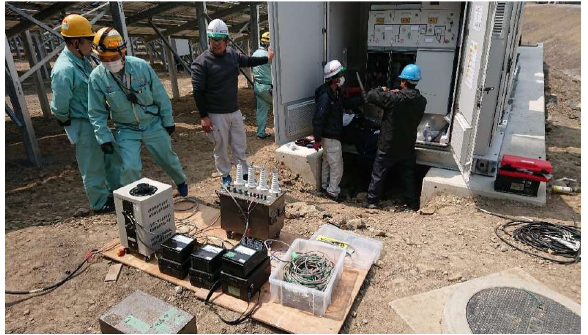
PCS 絶縁耐力試験
