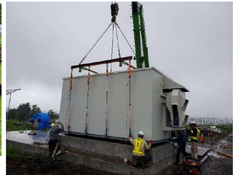
知内 750Kva PCS設置
