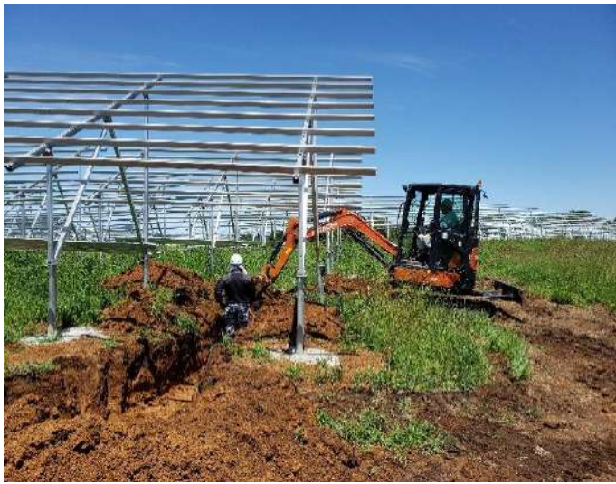
DC幹線埋設配管
